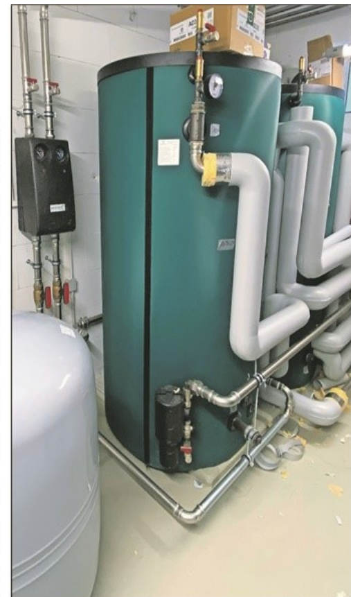
Für umweltfreundlichen Strom und Wärme für die Bewoh- ner sorgt ein modernes Blockheizkraftwerk.
